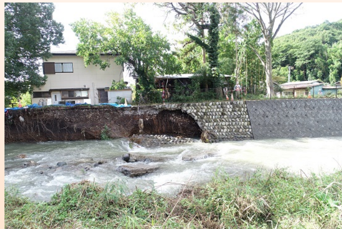
石積擁壁の基礎部が洗掘されて被災
