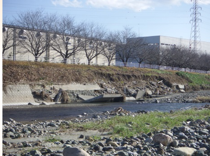
護岸基礎の洗掘により護岸被災
