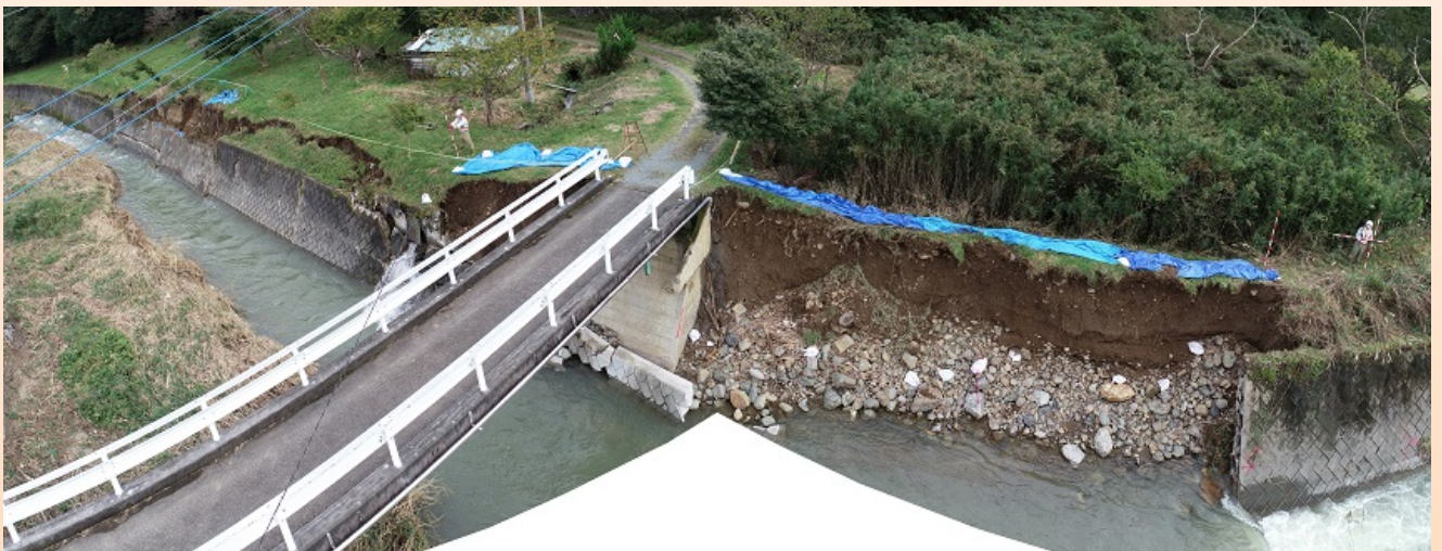
橋、橋台の左右のブロック積が破壊
