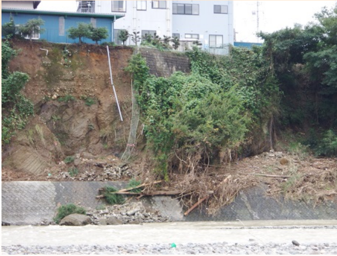
崖と基礎部擁壁が水流により流され 斜面が崩落
