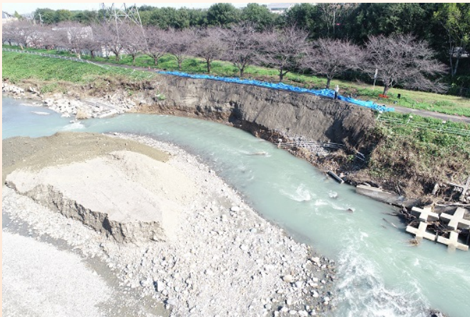
護岸と根固工の被災
