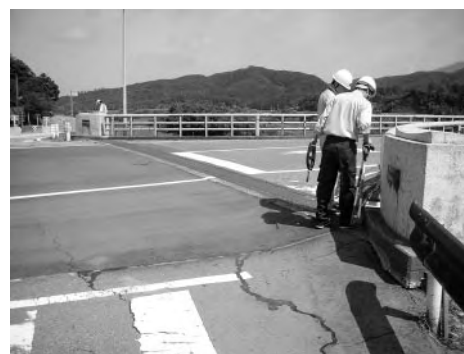
橋梁の被災状況調査
