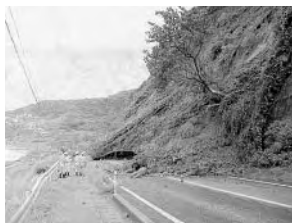
道路の被災状況調査
