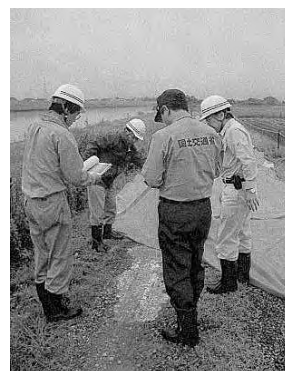
堤防の被災状況調査
