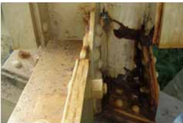
支柱の座屈（国道1号白川橋）
