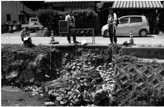
河川護岸の被災調査
