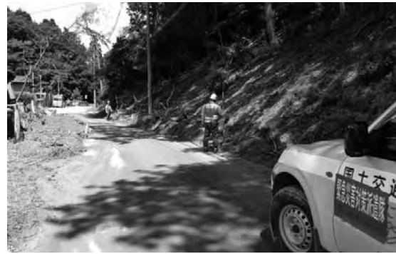
道路法面の被災調査
